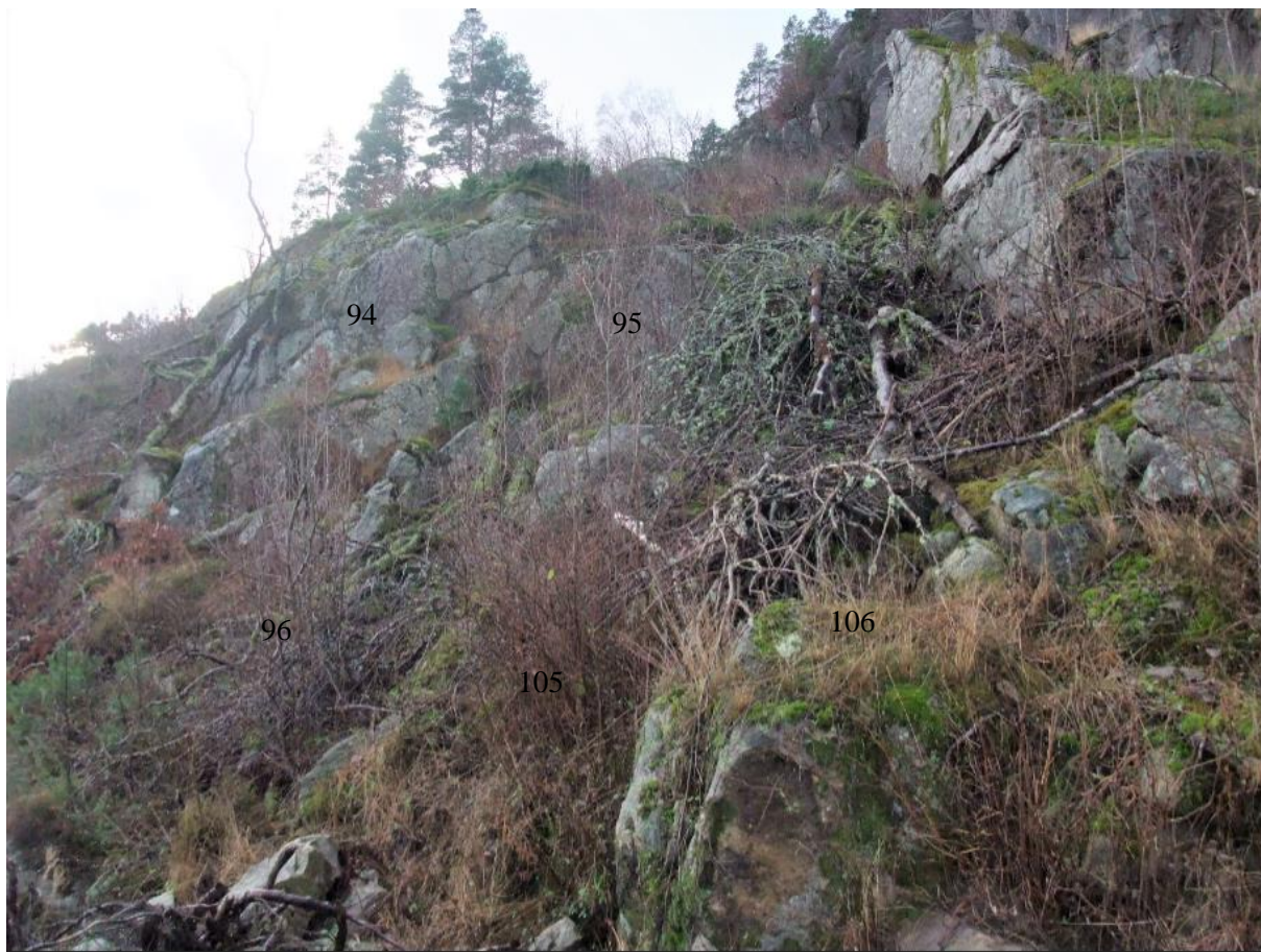
Figur 3 - Fjellskrent på oversiden av innkjørsel til FF1
